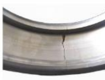
Трещина на дорожке качения
